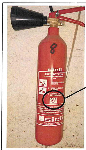
Extincteur de type B et d'équipement électrique.
